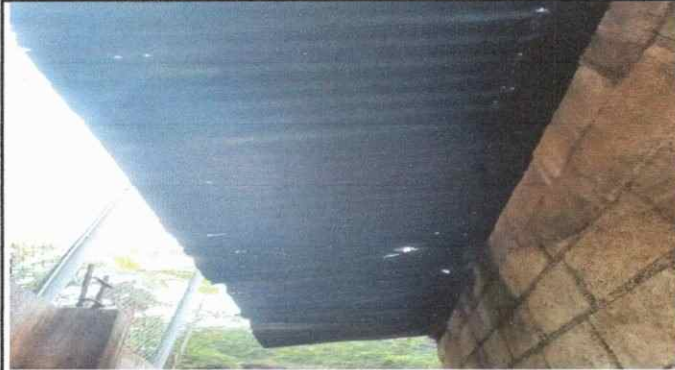
Techo en parte de atras de las aulas agujerado y doblado por los fuertes vientos
