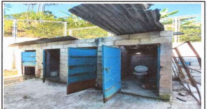
Techo de baños dañado en su totalidad por la tormenta.
