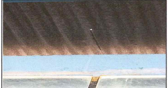
Laminas con goteras en la aulas.
