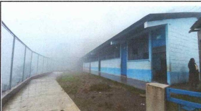
Techo de la escuela agujerado dañado durante las tormenta y vientos dañando materiales e incomodando a los estudiantes.
